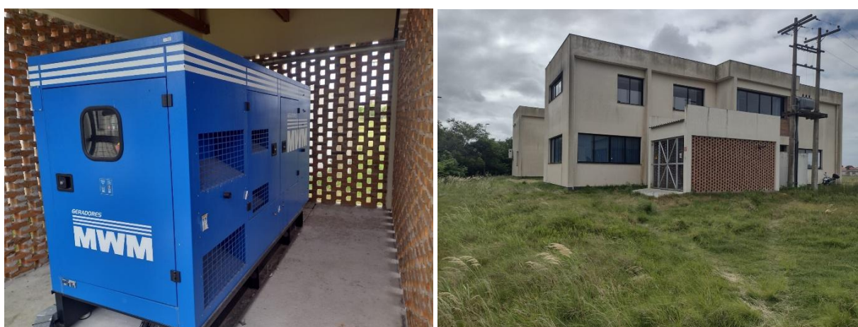
Figura 15. Instalação do gerador no Centro de Biodiversidade Subtropical (CBS-FURG), em operação desde dezembro de 2023.
